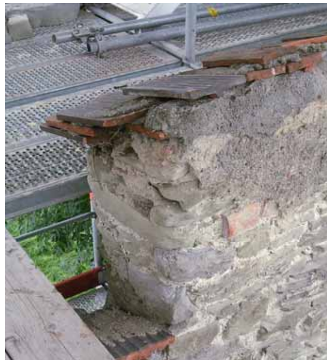
Zinne vor der Sanierung
